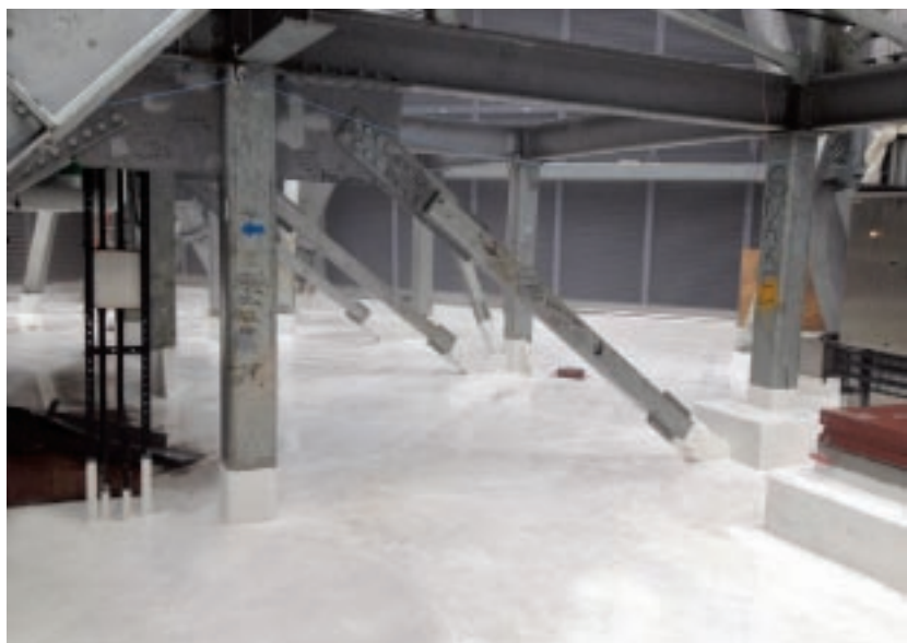
Hunderte von Anschlüssen und Durchdringungen auf engstem Raum gaben den Ausschlag für die KEMPEROL® Abdichtung.
